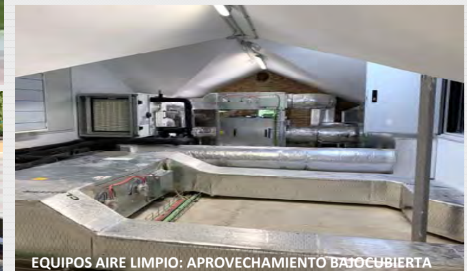
EQUIPOS AIRE LIMPIO: APROVECHAMIENTO BAJOCUBIERTA
