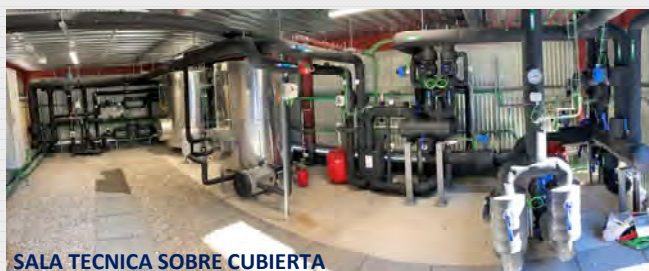
SALA TECNICA SOBRE CUBIERTA
