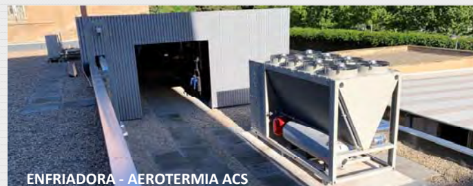
ENFRIADORA - AEROTERMIA ACS
